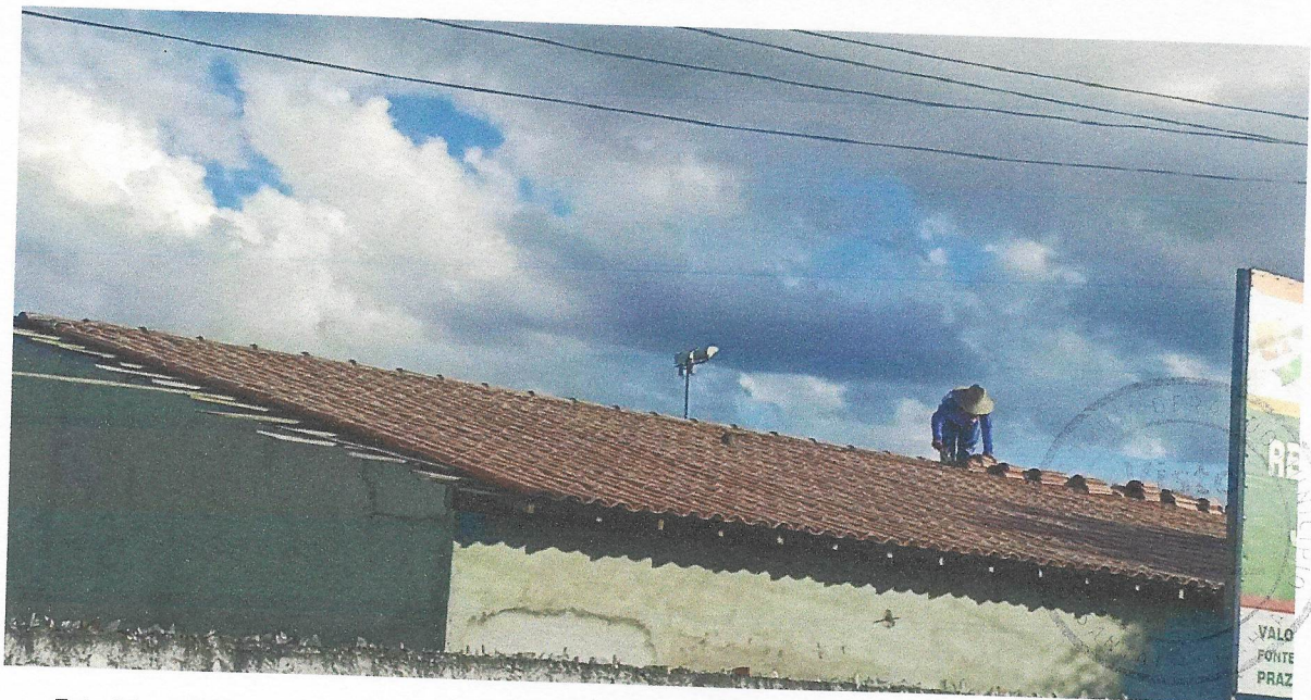
Foto 04 – RETIRADA E RECOLOCAÇÃO DE CAIBRO EM TELHADOS DE ATÉ 2 ÁGUAS COM TELHA CERÂMICA CAPA-CANAL, INCLUSO TRANSPORTE VERTICAL. AF_07/2019
