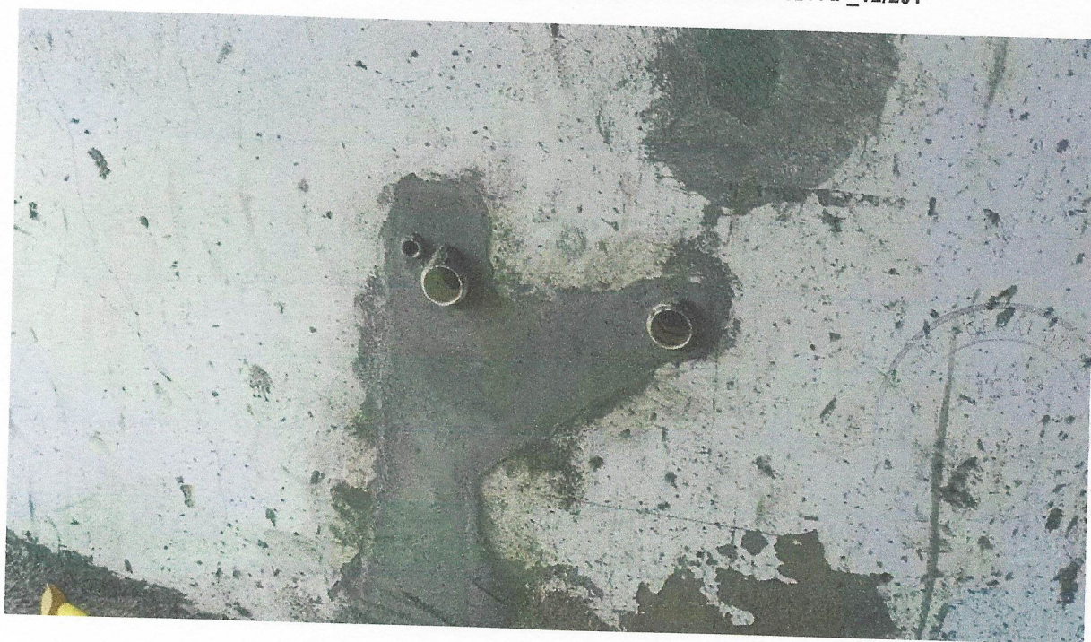
Foto 10 - Ponto de esgoto com tubo de pvc rígido soldável de Ø 40 mm (lavatórios, mictórios, ralos sifonados, etc...)
