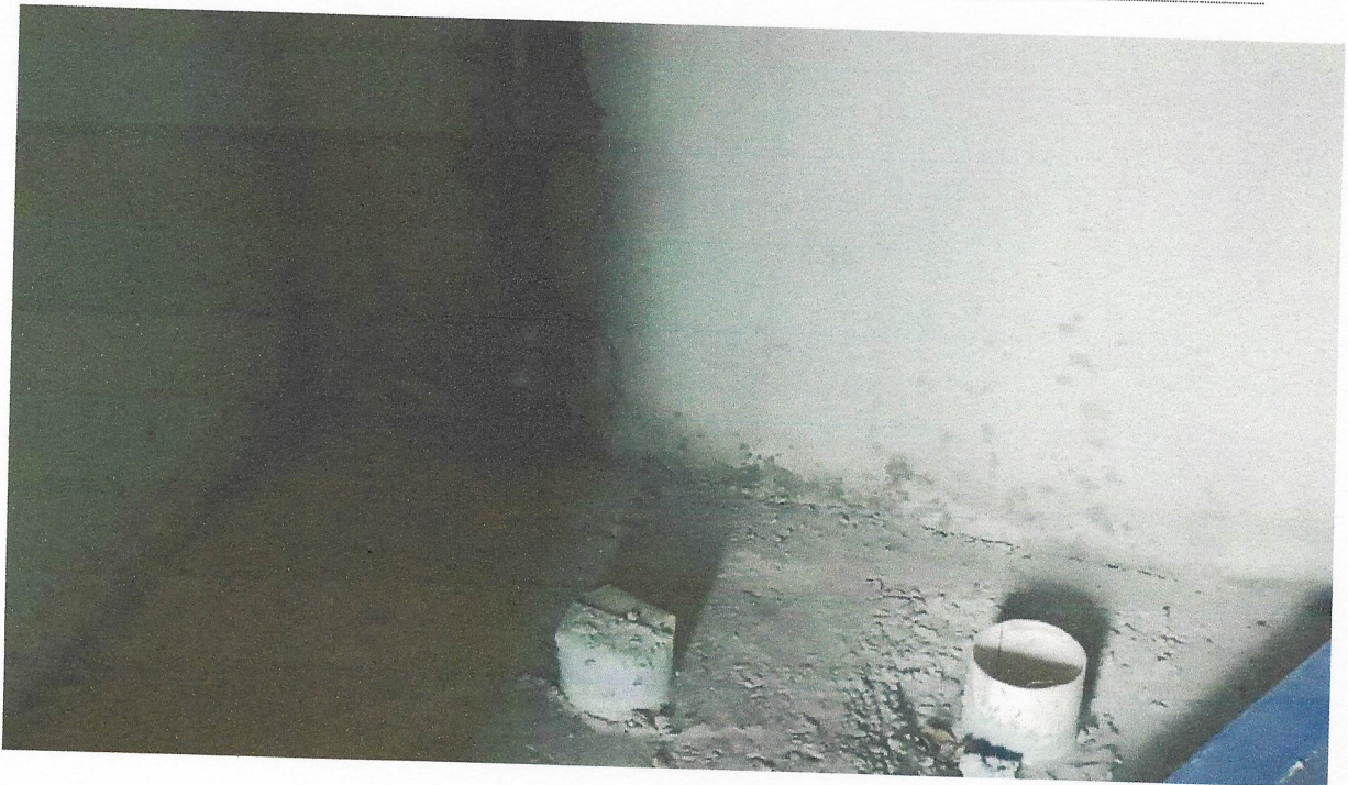
Foto 07- JOELHO 90 GRAUS, PVC, SOLDÁVEL, DN 25MM, INSTALADO EM RAMAL OU SUB-RAMAL DE ÁGUA - FORNECIMENTO E INSTALAÇÃO. AF_12/2014
